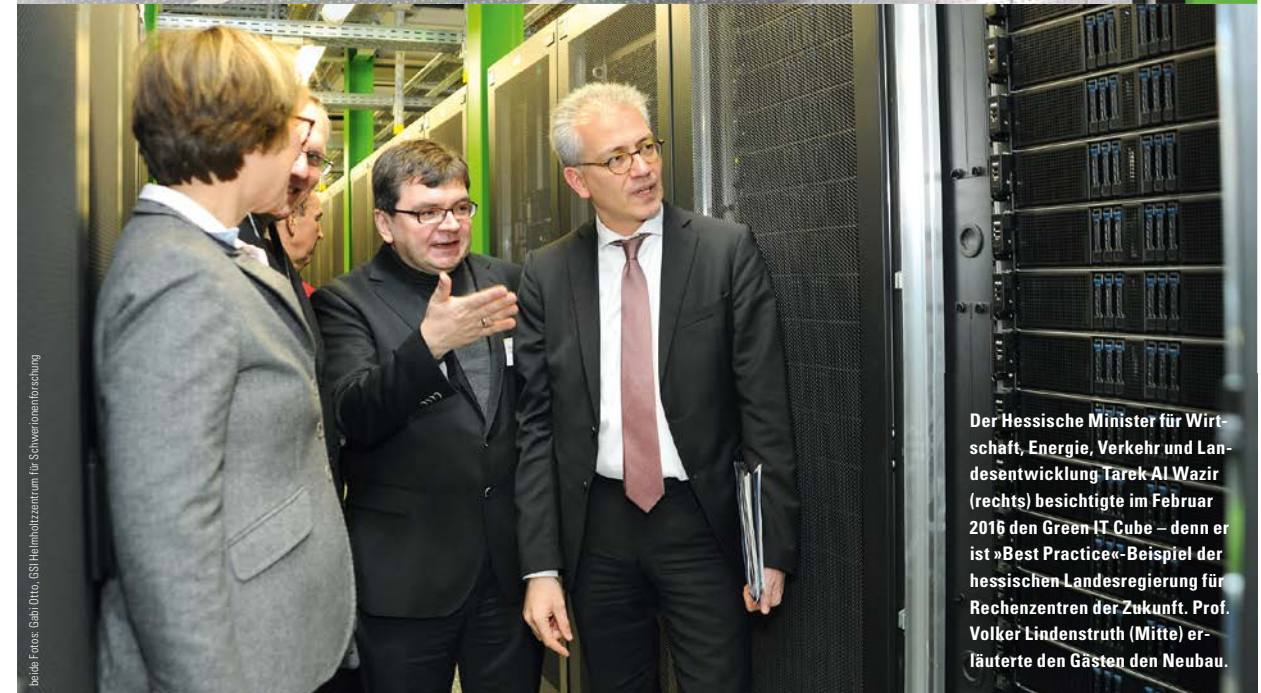
768 Computerschränke wird das Großrechenzentrum »Green IT Cube« am Darmstädter GSI Helmholtzzentrum für Schwerionenforschung fassen. Aufgrund der platzsparenden Architektur und einer speziellen Kühlung können im Vergleich zu konventionellen Supercomputern jährlich mehr als 15.000 Tonnen an CO2-Emissionen eingespart werden.
